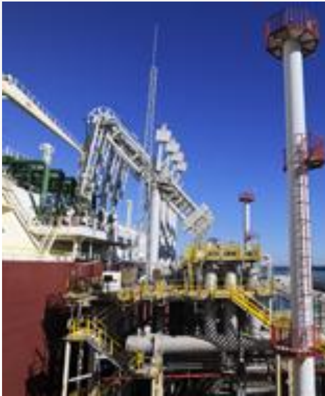
Bracci di scarico del GNL
